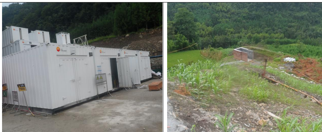
图 5.3-1 类比同类型钻井工程已建发电房和燃烧池现场实景图
