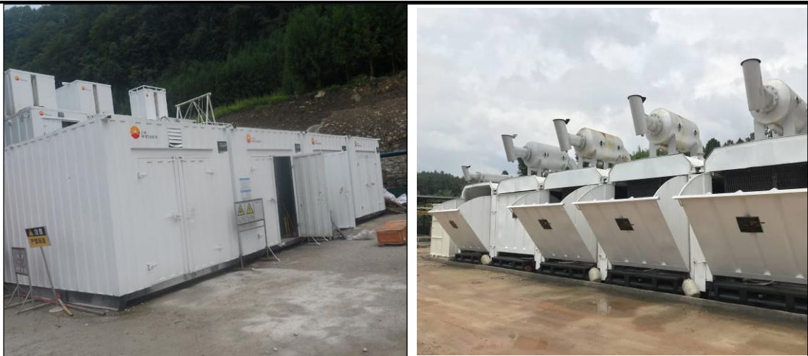
图 5.3-4 类比建设单位其他井站发电房噪声防治措施实照
